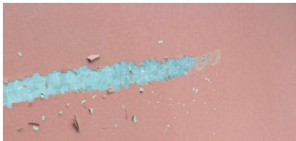
Bild till höger: Dålig vidhäftning. Avrensas totalt!
